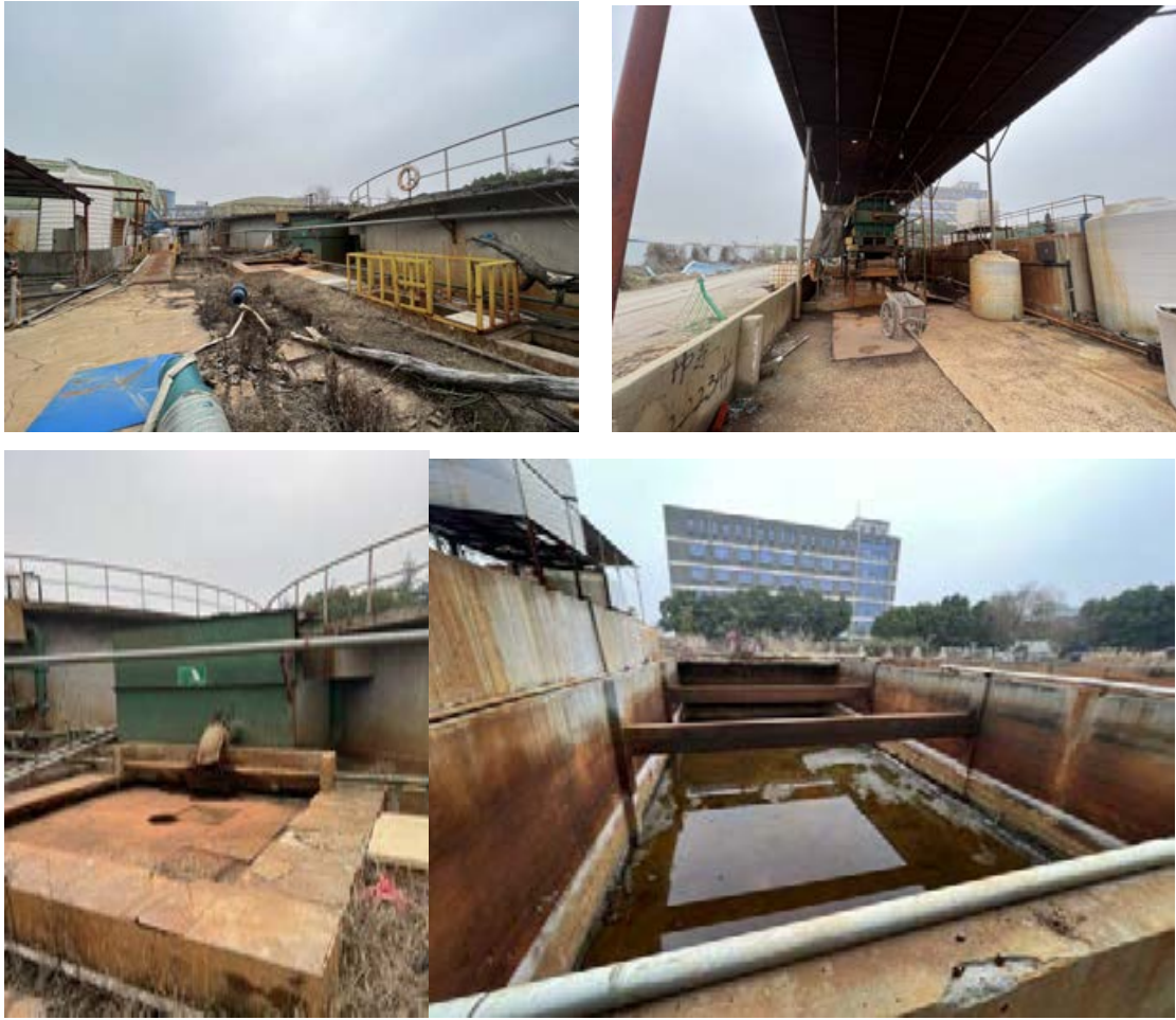
图 2.5-11 污水处理设施（2022 年 12 月）
